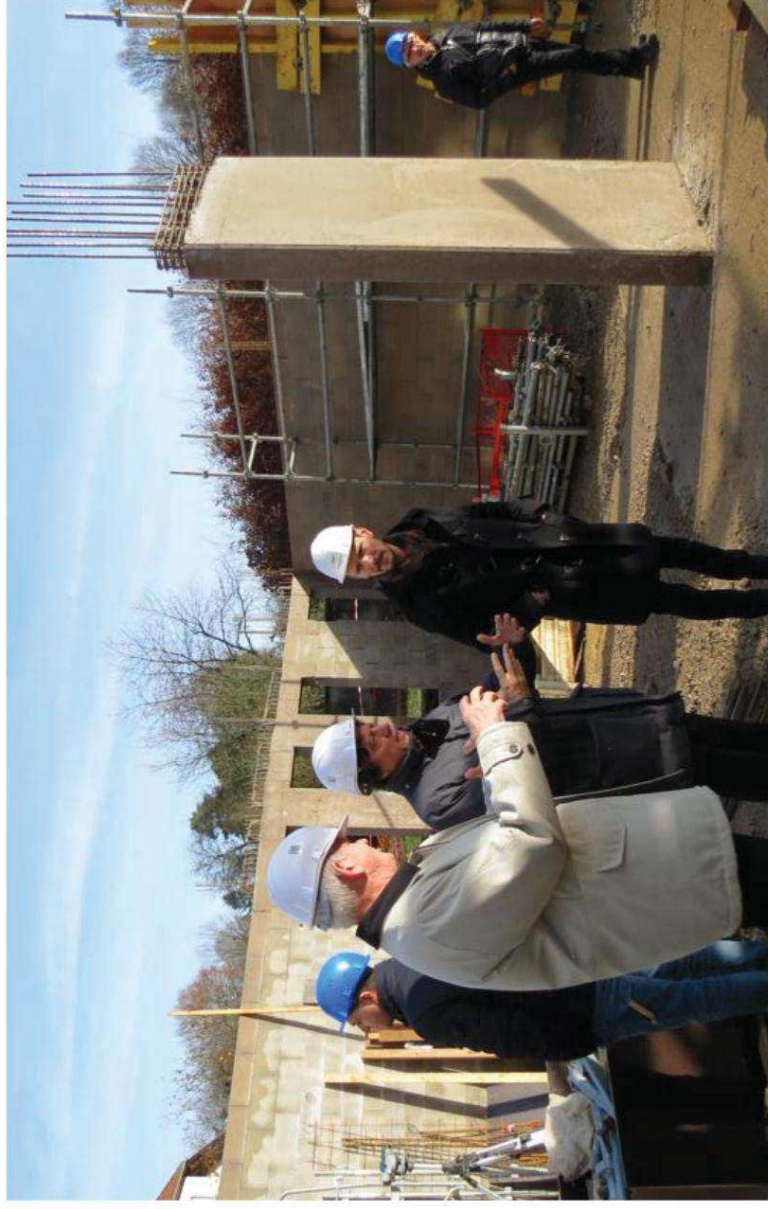
Ce mardi, lors d'une réunion de chantier, en présence du maire Gérard Pelleteret, Pascal Mathis, directeur du Groupe Hospitalier de Haute-Saône a fait le point avec l'architecte sur l'avancement du chantier de l'extension de l'Ehpad Gribouillard. Photo Ch.L.
